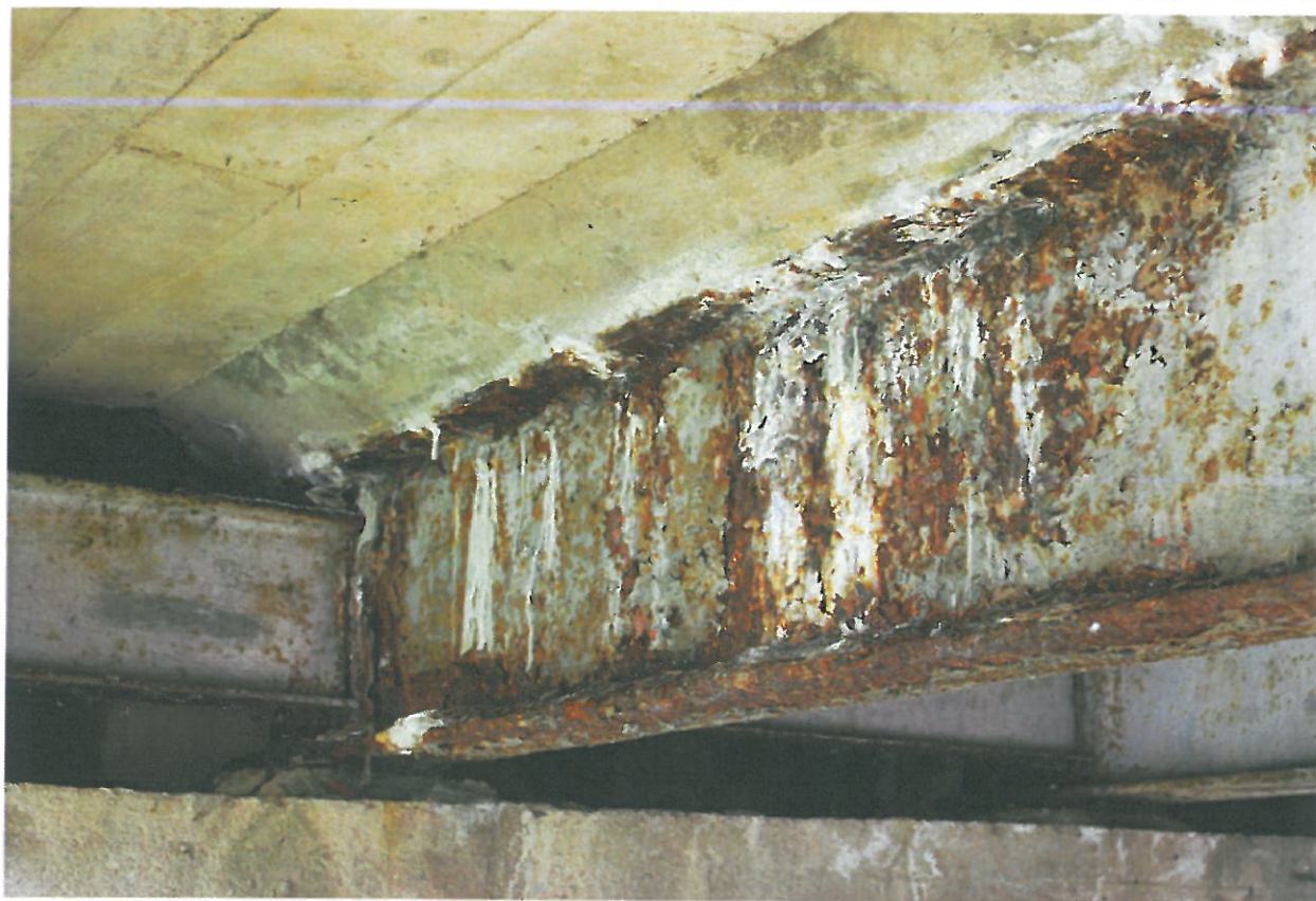
Fot. 17. Zniszczenie zabezpieczeń antykorozyjnych, korozja i zanieczyszczenia konstrukcji stalowej mostu.
