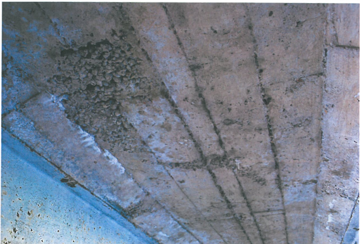
Fot. 16. Ubytki betonu, zacieki i wykwity świadczące o braku skuteczności izolacji płyty pomostu.
