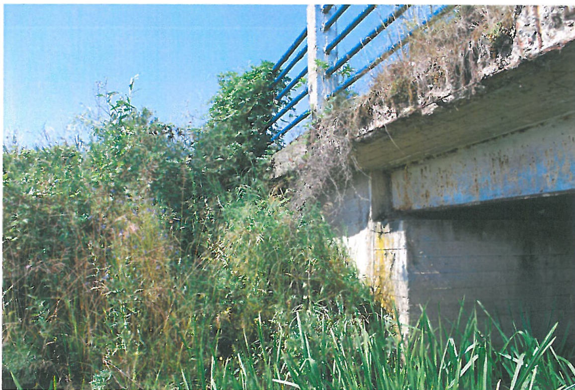
Fot. 6. Wegetacja roślin oraz zanieczyszczenia stożka od strony południowej – widok od strony górnej wody.
