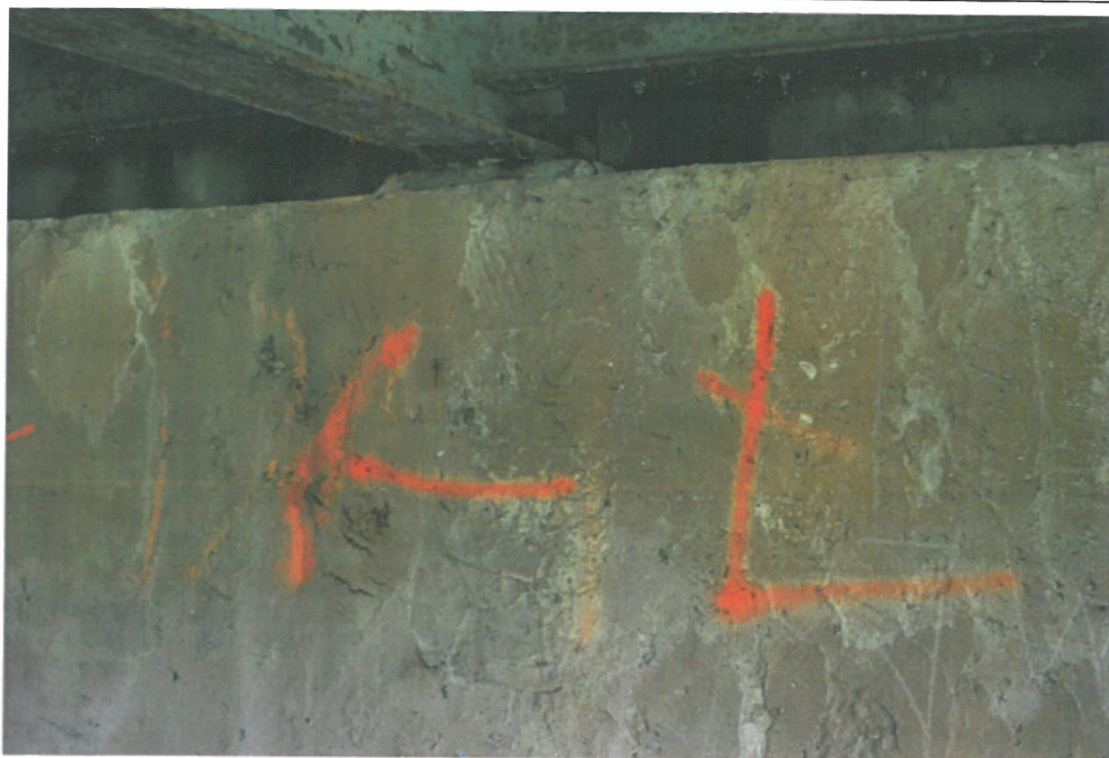
Fot. 22. Zanieczyszczenia, ubytki betonu i rysy przyczółka – widok od strony północnej.
