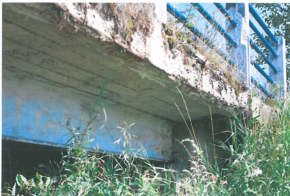
Fot. 14. Wegetacja roślin, zanieczyszczenia, ubytki betonu i korozja zbrojenia gzymsu – widok od strony górnej wody.
