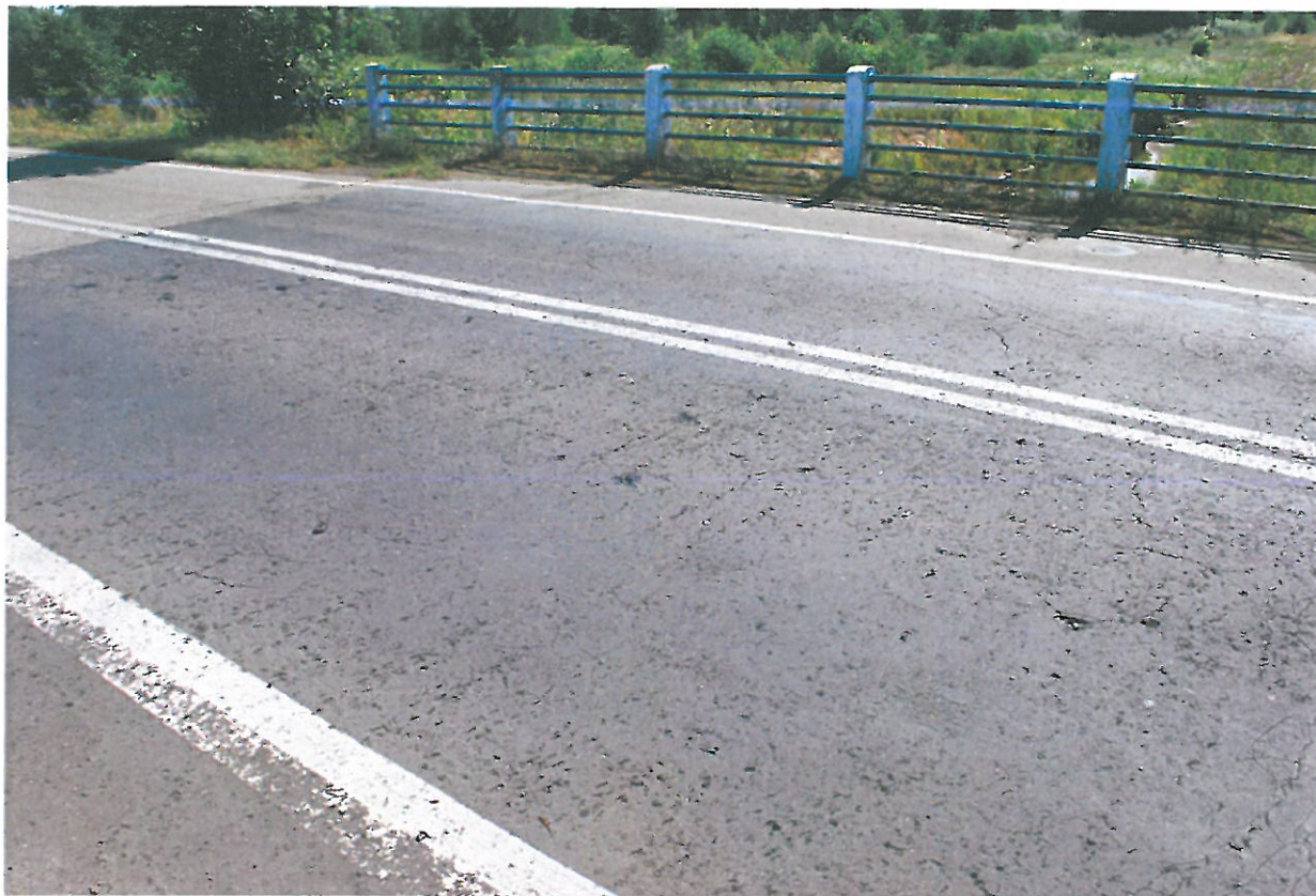
Fot. 9. Rysy, ubytki, deformacje nawierzchni jezdni na moście.
