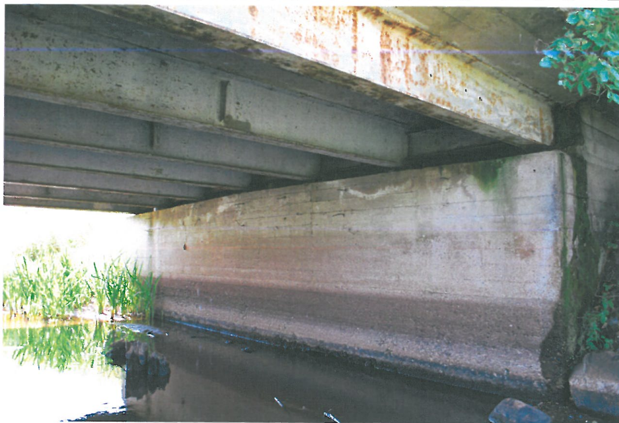
Fot. 23. Wegetacja roślin i zacieki przyczółka świadczące o nieszczelności dylatacji bitumicznej – widok od strony południowej.
