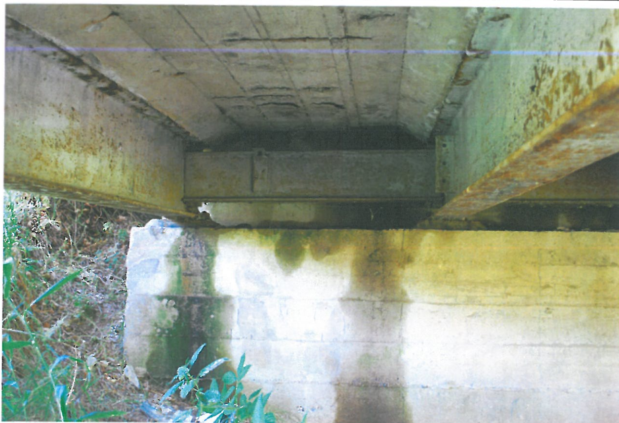
Fot. 21. Wegetacja roślin i zacieki przyczółka świadczące o nieszczelności dylatacji bitumicznej – widok od strony północnej.
