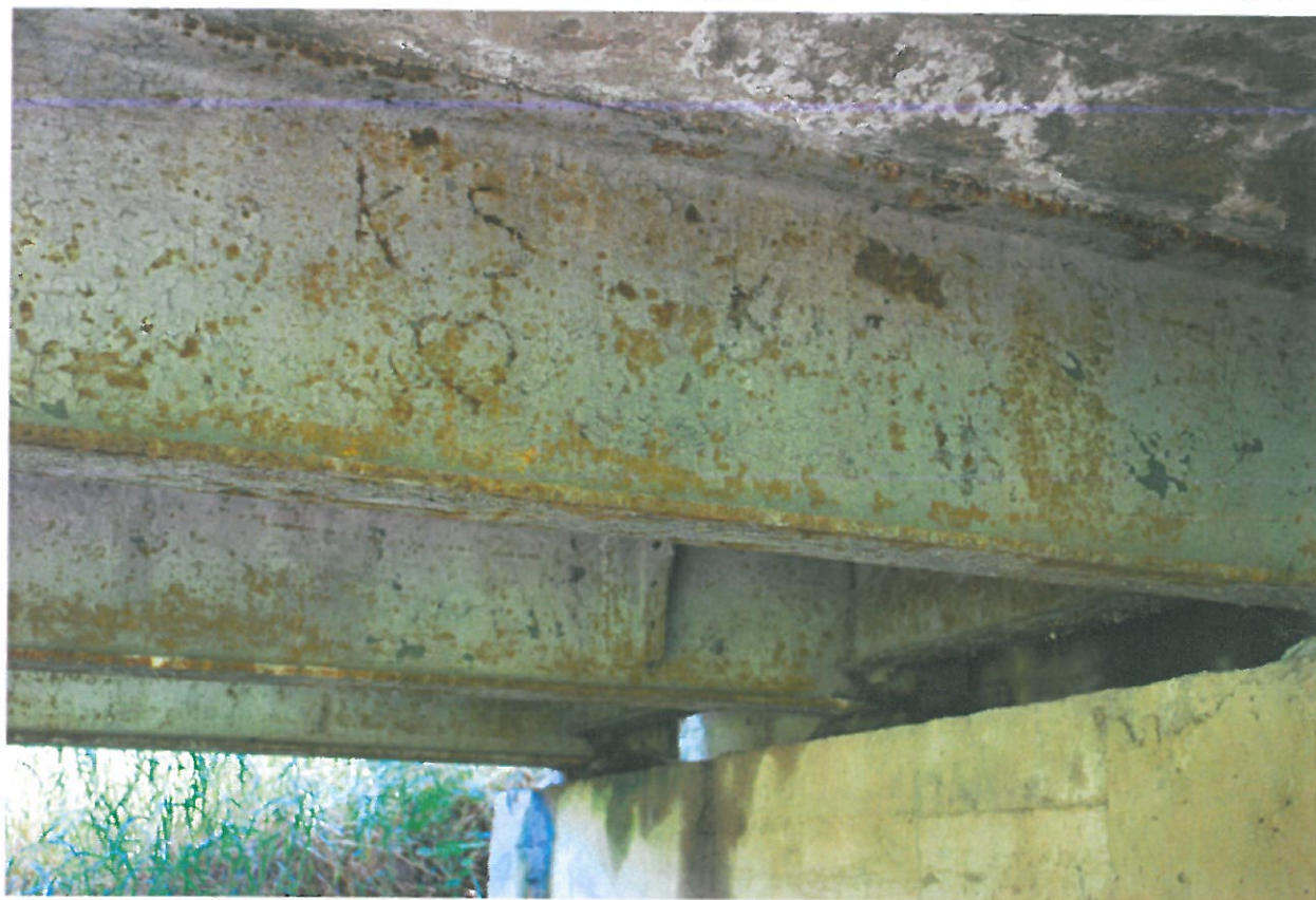
Fot. 19. Zniszczenie zabezpieczeń antykorozyjnych, korozja i zanieczyszczenia konstrukcji stalowej mostu.
