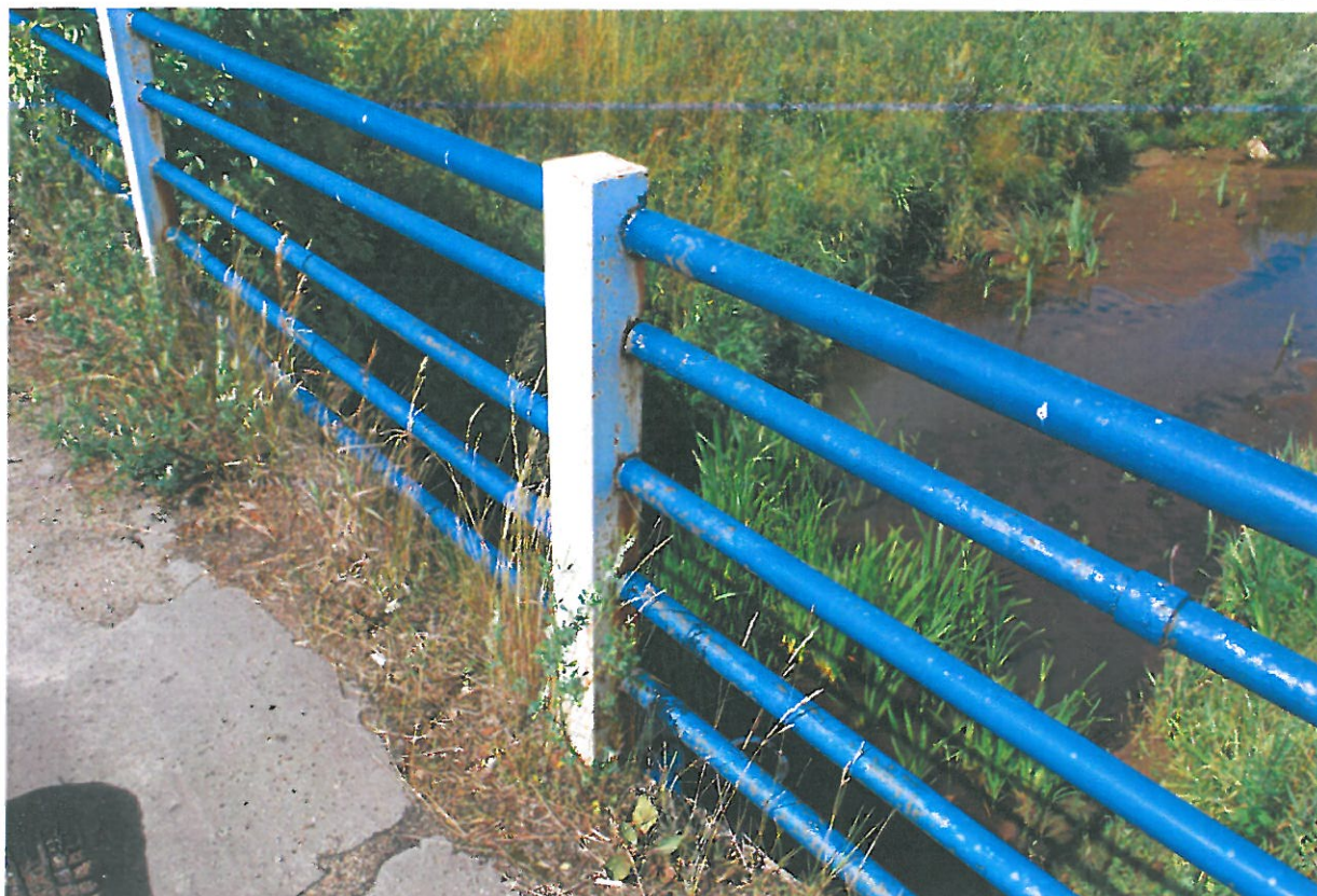
Fot. 11. Zniszczenie zabezpieczeń antykorozyjnych oraz korozja przeciągów i słupków balustrady – widok od strony dolnej wody.
