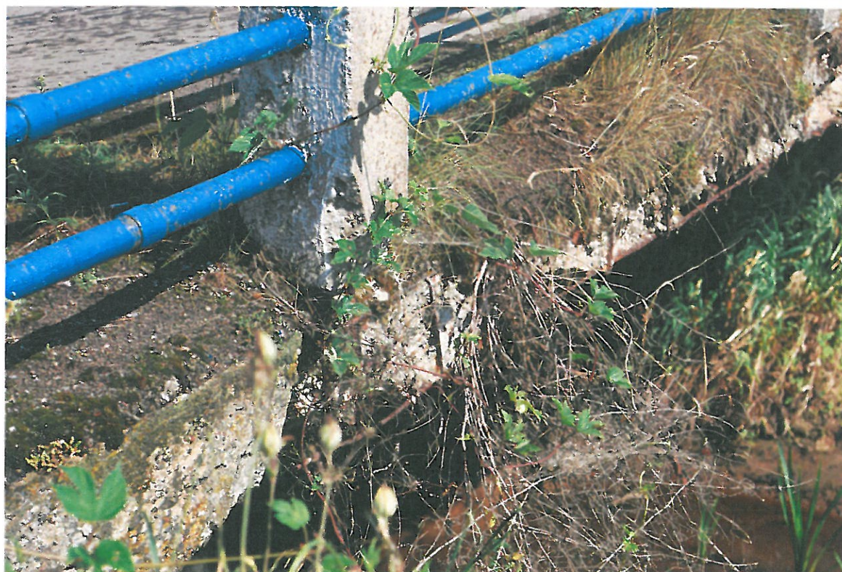
Fot. 12. Ubytki betonu słupka balustrady. Degradacja zakotwienia słupka - widok od strony górnej wody.
