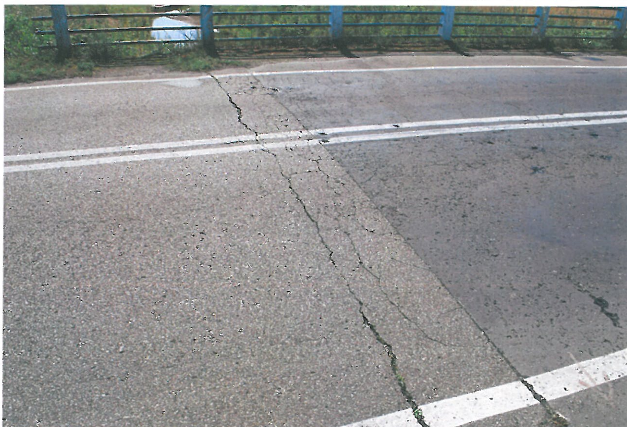
Fot. 8. Rysy, ubytki, deformacje nawierzchni jezdni na dojeździe od strony północnej.
