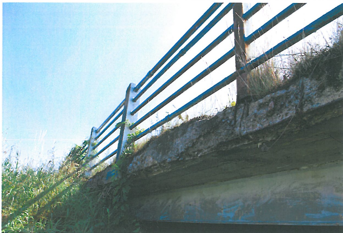
Fot. 13. Wegetacja roślin, zanieczyszczenia, ubytki betonu i korozja zbrojenia gzymsu – widok od strony dolnej wody.
