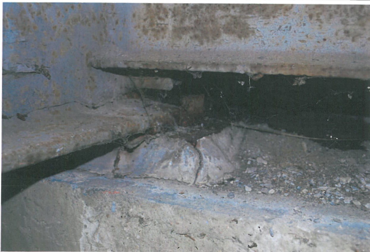
Fot. 20. Zniszczenie zabezpieczeń antykorozyjnych, korozja i zanieczyszczenia łożyska stalowego.
